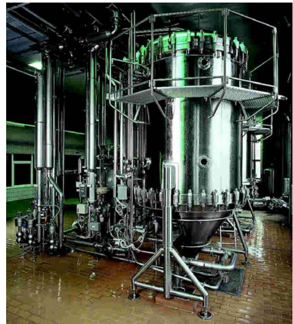
Bild 2: Typische Kieselgur Filtrationsanlage
